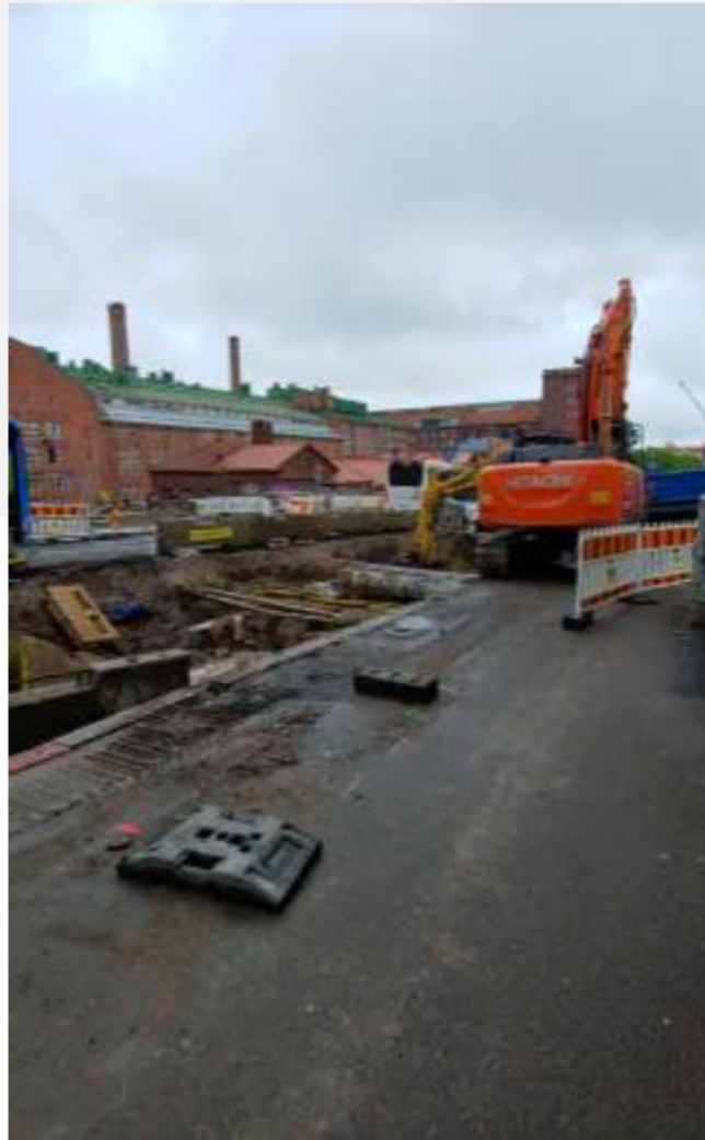
05.06.2020 10:26 Työmaa-aitaus poistettu jalkakäytävän puolelta kaivannon kohdalta ja avoin kohta oli valvoton.
