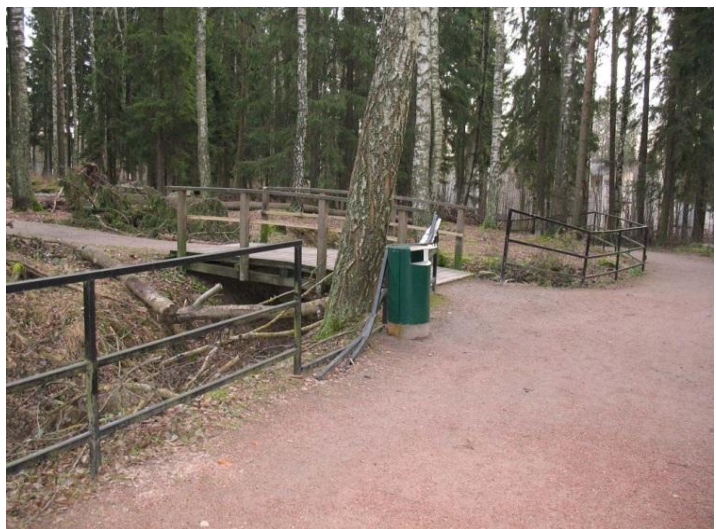
Kaatonut puu on vaurioittanut rakenteita viheralueella
